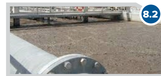
EDAR d'Arenals del Sol.
