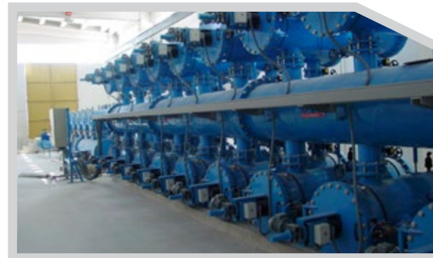
Estació de filtrat embassament La Peña.
