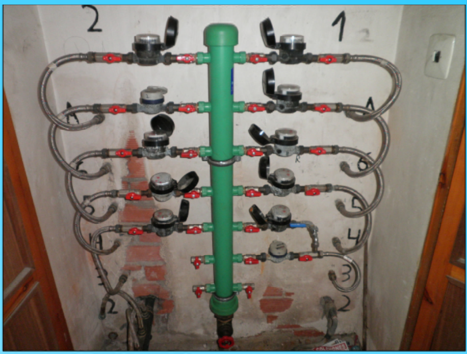
BATERÍA DE CONTADORES
