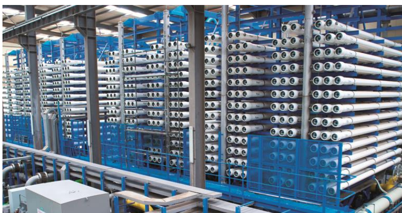
Figura 6.7. Bastidores de ósmosis inversa (Fuente: TecnoAgua)
